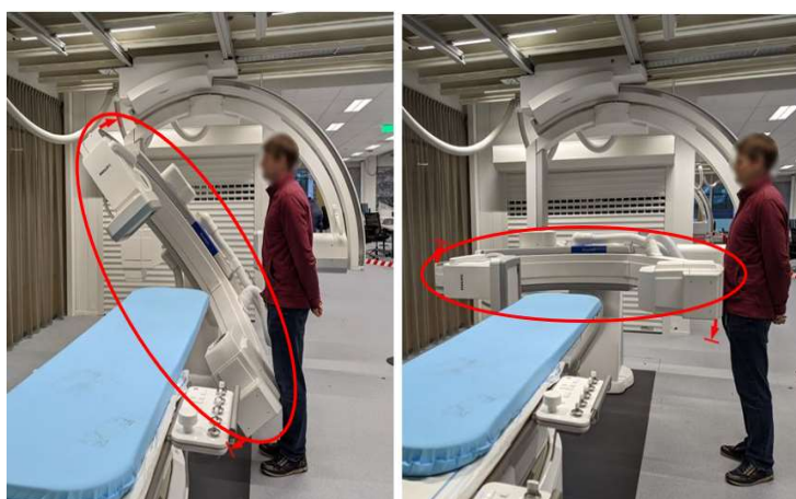
Figura 3: Mișcări neregulate ale brațului C (cerc roșu) din cauza șurubului rupt de fixare a motorului elicei.
